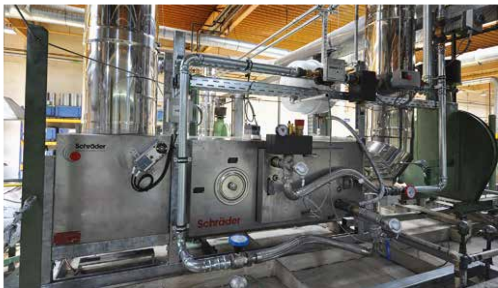
Bild unten: Abgaswärmetauscher auf den Härteöfen (Bilder: Schröder Abgastechnologie)
