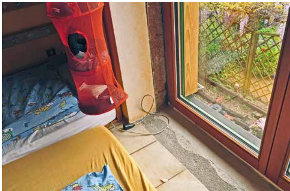
Die potenziellen Wärmebrücken an Fenstern und Balkontüren sind mit einer Isolierschüttung derart minimiert, dass sie KfW 55 nicht gefährden
