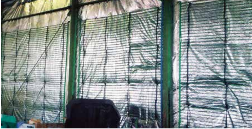
Reflektionsfolie hinter den im Boden oder in der Decke verlegten Elementen gestatten selbst bei der Außenwandmontage einen verlustarmen Betrieb, sodass die Heizung mit diesen Vorlauftemperaturen gefahren werden kann. Im Bild die Sanierung einer Industriehalle
