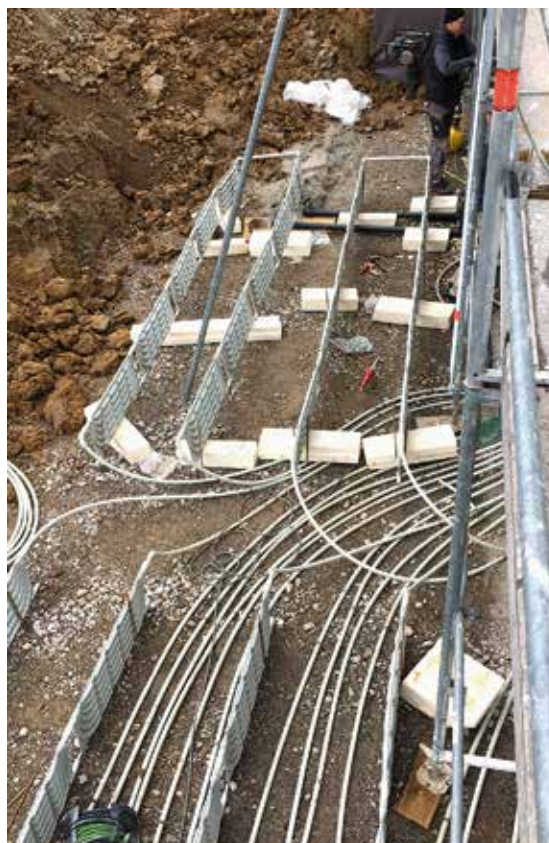
Neubau Markgröningen, Einbetten der Absorber in den üblichen Arbeitsraum vor der Kelleraußenwand
