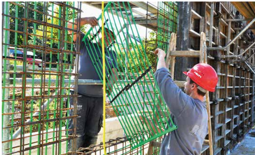
Installation der Wandelemente in Markgröningen. Ihre Wärmeleistung sollte im Trockenbau etwa 30 W/m 2 betragen, im Nassbau/Betonkernaktivierung 50 W/m 2
