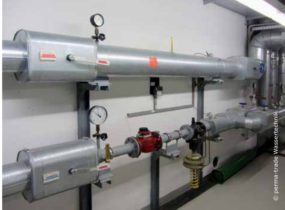
Das Bundesverfassungsgericht besteht aus mehreren Gebäudekomplexen, die via Fernheizung über zwei Wärmetauscher mit 400 kW und 800 kW Leistung beheizt werden
