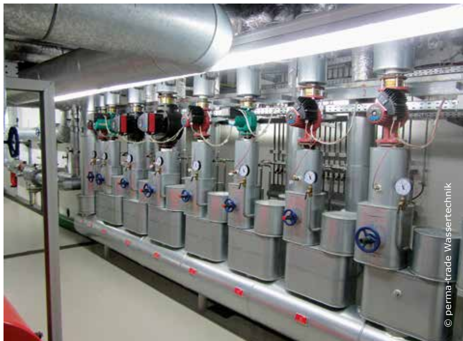
Ein Blick in den Heizraum mit dem Heizungsverteiler: Dank der Inline-Entsalzungsmethode permaLine PT-IL 20 lassen sich selbst weit verzweigte und komplexe Füllwasseraufbereitungen einfach umsetzen
