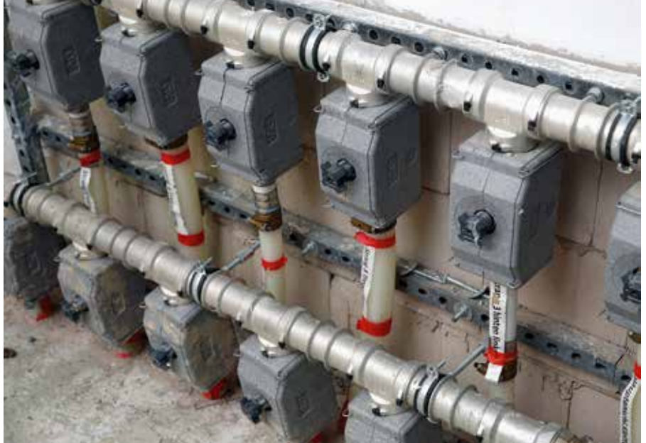
Der Heizkreisverteiler in der Pellet-Heizzentrale wurde einfach aus dem modular aufgebauten Uponor Verbundrohrsystem für Verteil- und Steigleitungen zusammengesetzt
