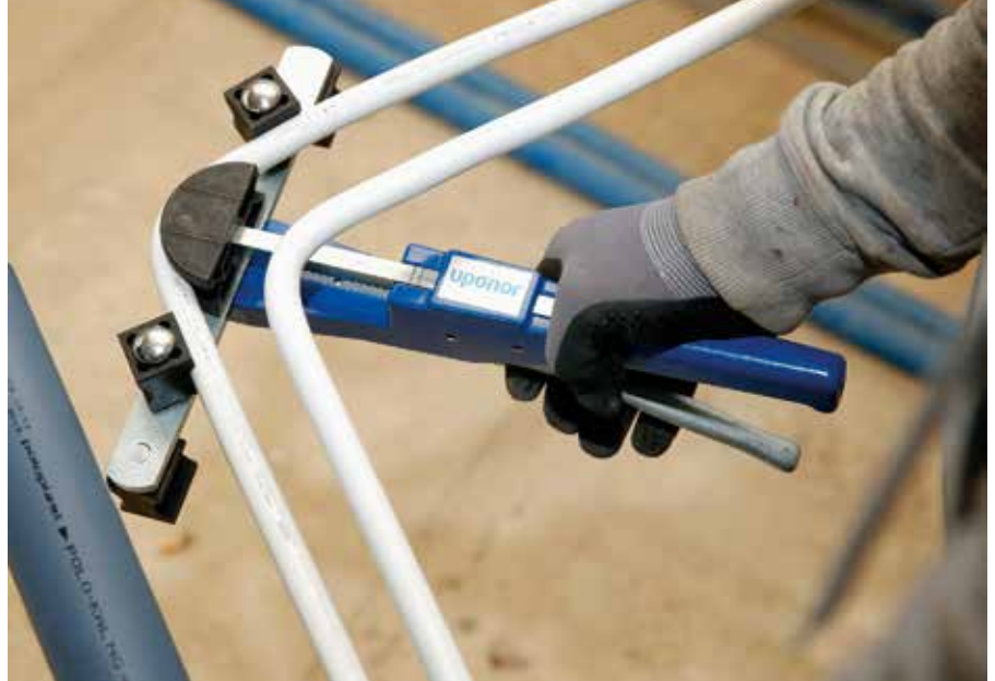
Für die Steigleitungen, die Durchschleif-Ringinstallation sowie die Anbindung der Heizkörper wurde durchgehend das vorisolierte Mehrschichtverbundrohr Uni Pipe PLUS verwendet, das sich vor allem durch hohe Biegeflexibilität und Formstabilität auszeichnet. Hierzu gibt es auch eine passende Biegezange
