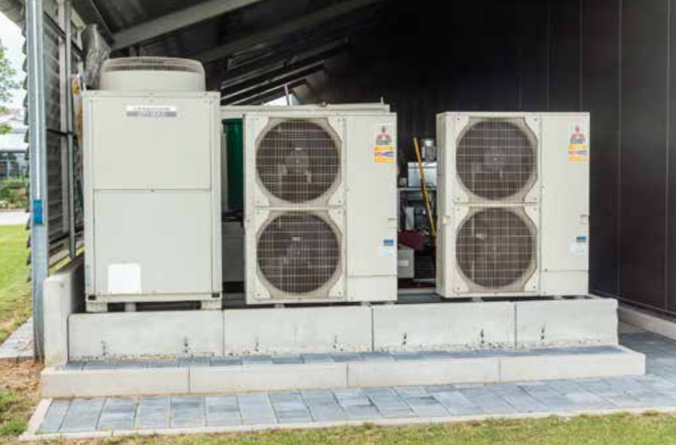
VRF-Klimagerät und Luft-Wasser-Wärmepumpen
