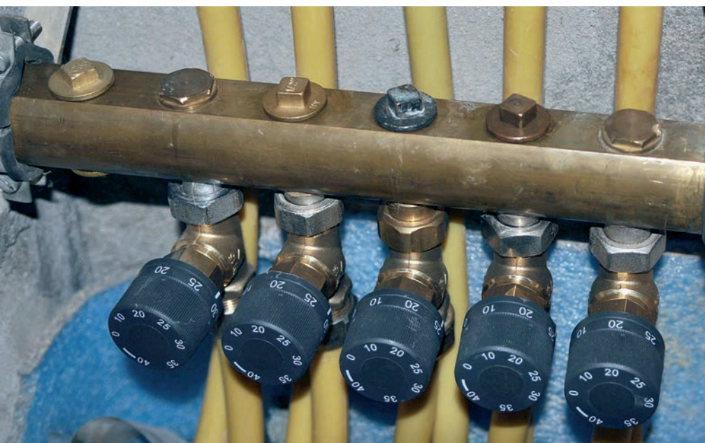
Rücklauftemperaturbegrenzer für die verschiedenen Heizkreise im Verteilerschrank des Objekts Bärhausen
