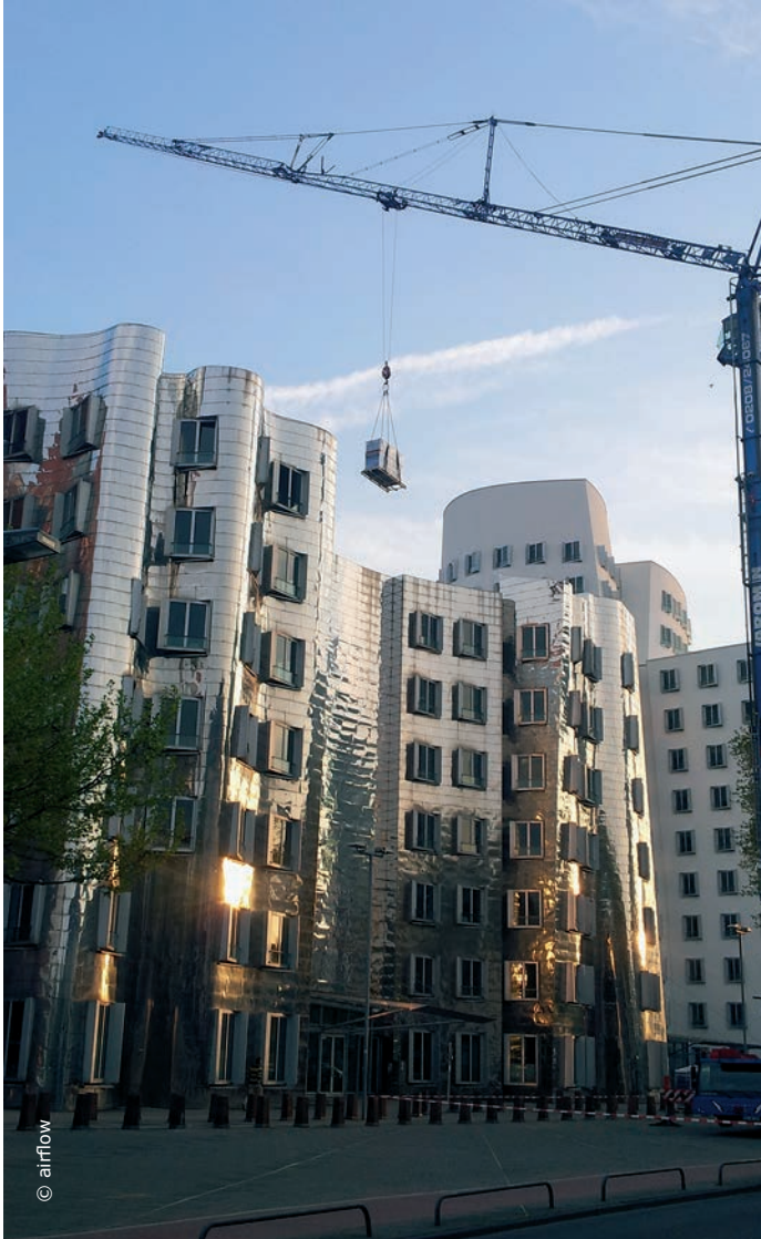
Bild links: Platzmangel im Inneren des Gebäudes machte eine Einbringung über das Dach nötig
