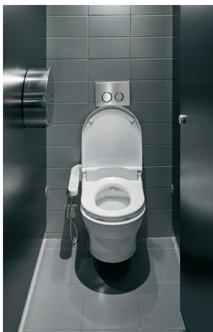
WASHLET EK 2.0 in einer Personaltoilette (Bilder: Francis Amiard)
