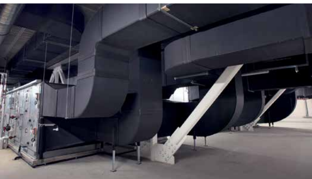
Auch Luftkanäle wurden mit einer AF/Armaflex Dämmung vor der Bildung von Tauwasser geschützt (Foto: Armacell)
