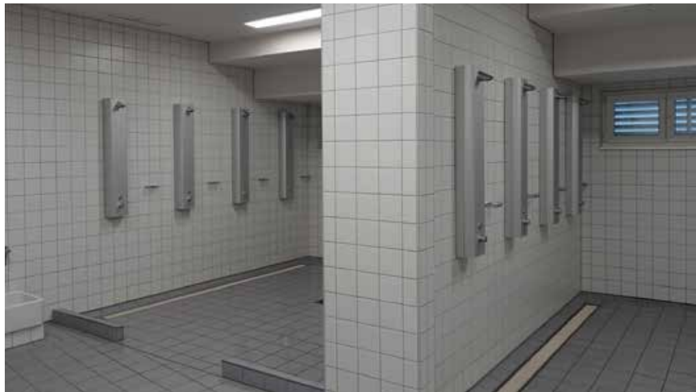
In den renovierten Duschbereichen sorgen die Duschpaneele „Linus DP-C-T“ Armaturentechnologie für Hygiene, einfache Handhabung und Wirtschaftlichkeit.
