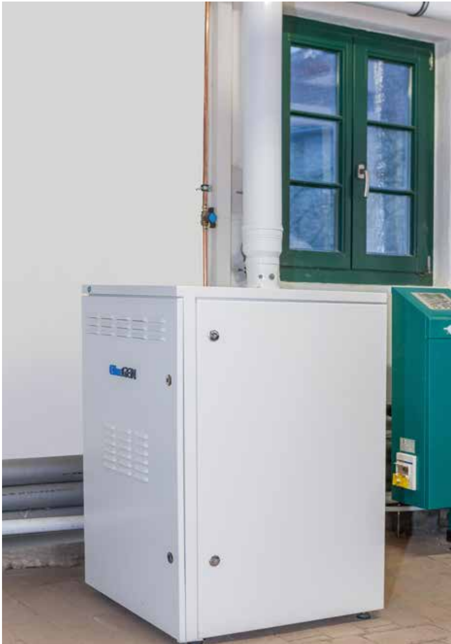
Im Heizungsraum des Anwesens wurde der tausendste hergestellte Bluegen installiert. Hier produziert er jährlich bei einer konstanten Ausgangsleistung von 1,5 kW bis zu 13.000 Kilowattstunden Strom.
