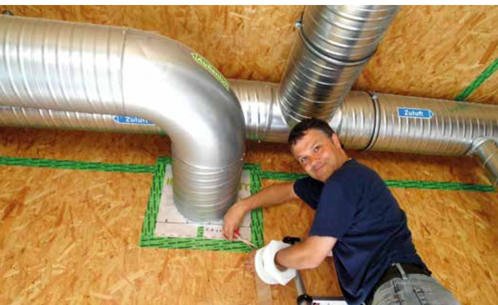
Damit jeder den Weg der Luft verfolgen kann, wurden die Lüftungskanäle beschriftet. So wird verdeutlicht, woher die Luft kommt und wo sie hingeht. Ganz nach dem Kon- zept des Schulungsgebäudes wird hier die Technik sichtbar und verständlich dargestellt.
