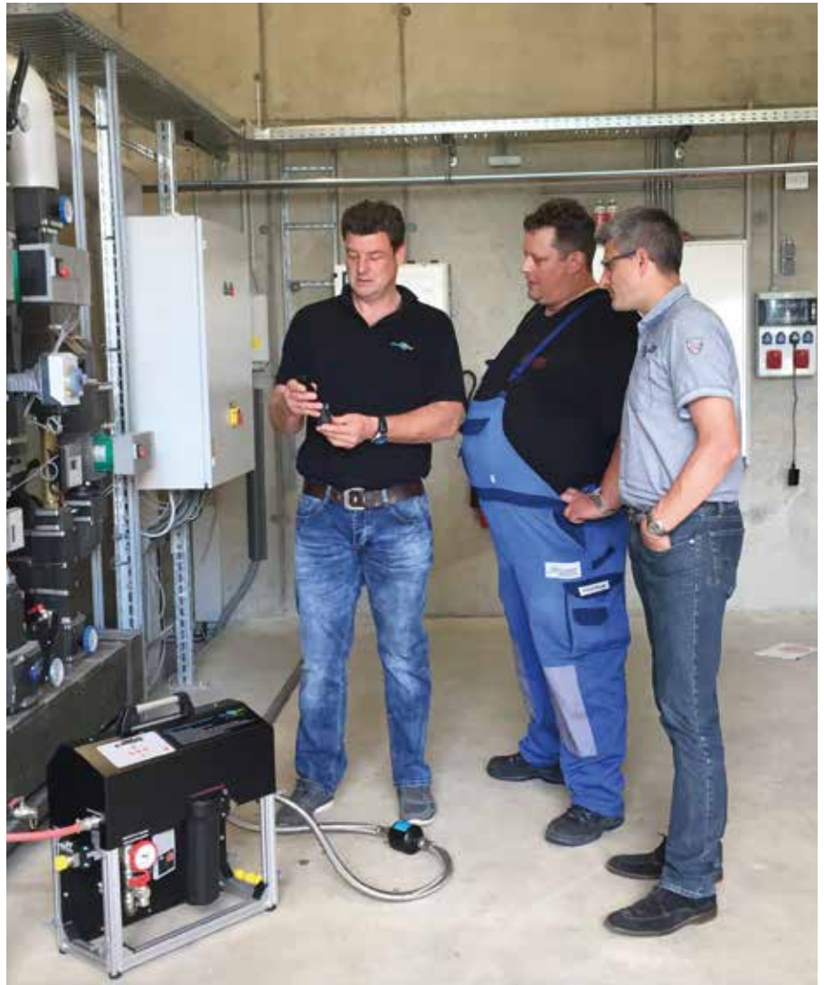
v.l. Achim Brunner (perma-trade Gebietsleiter), Philipp Burger (Firma Schöllhammer) und Christian Class (Planungsingenieur) kontrollieren vor dem Zusammenschluss der beiden Heizkreisläufe die Füllwasserqualität in beiden Anlagen.
