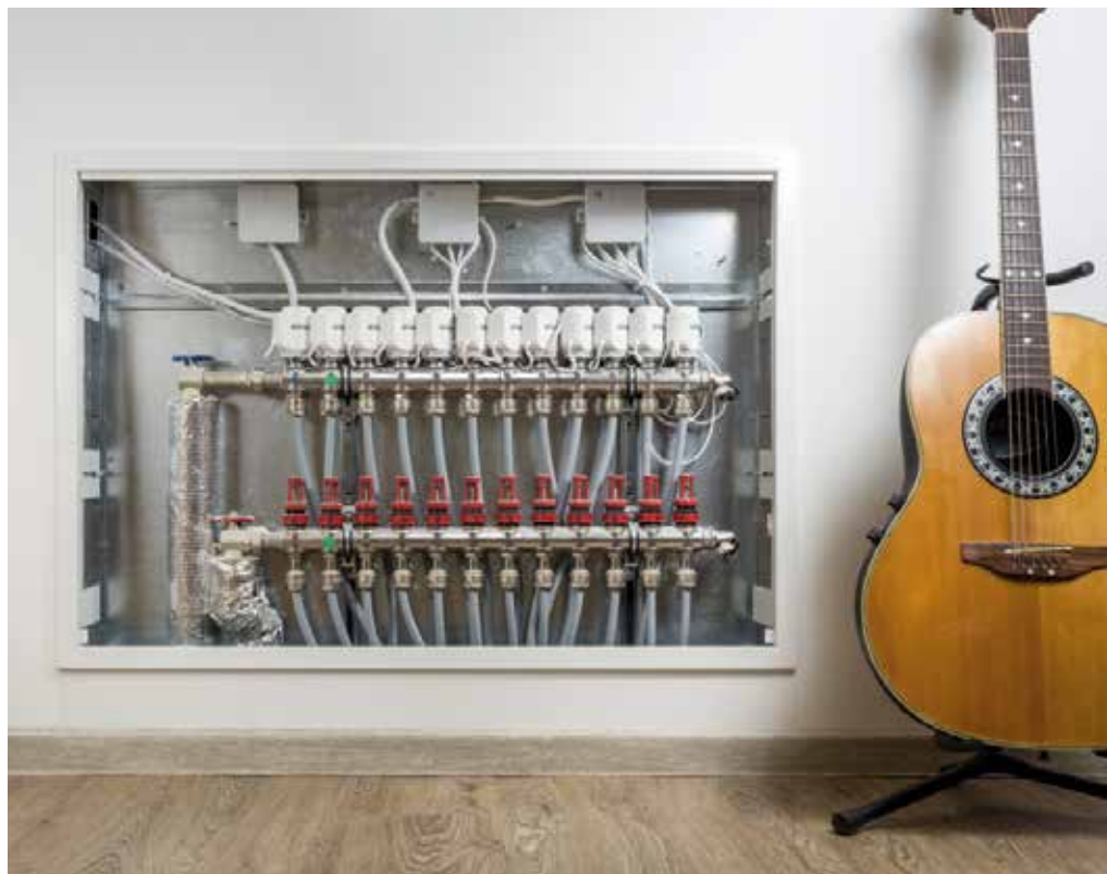
Der Heizkreisverteiler sorgt für einen gleichmäßigen Wärmeeintrag in die Räume.
