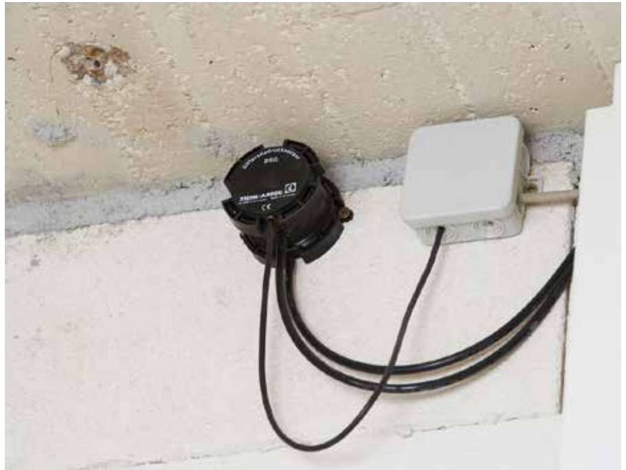
Entsprechend der realen Druckverhältnisse, die ein Sensor an die Steuerung meldet, wird die Drehzahl der Entrauchungsventilatoren geregelt – entweder über Frequenzumformer oder über EC-Motoren..
