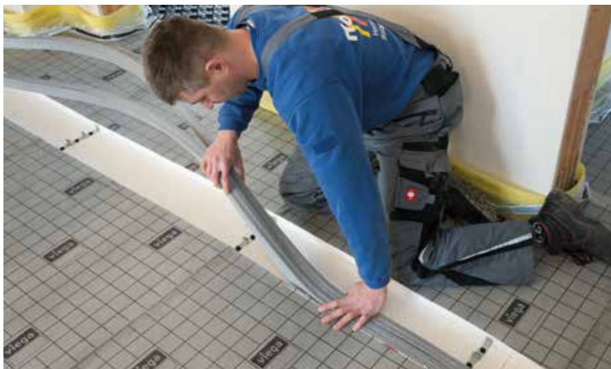
Vierter Schritt im Montageablauf: Der Monteur setzte die Befestigungsschellen für die Dämmschläuche in die Ausschnitte und verlegte die Dämmschläuche.
