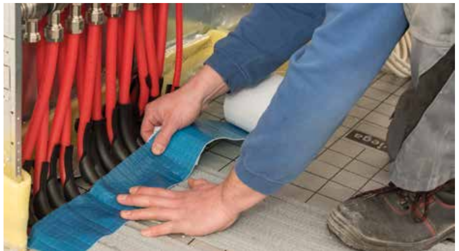
Zum Schluss brachte Fachhandwerker Schmid Klebestreifen dort an, wo die Zuleitungen aus der Dämmebene austreten: am Heizkreisverteiler und den Tüрдurchgängen. Das schützt gegen den Eintritt von Estrichwasser und verhindert somit Schallbrücken.
