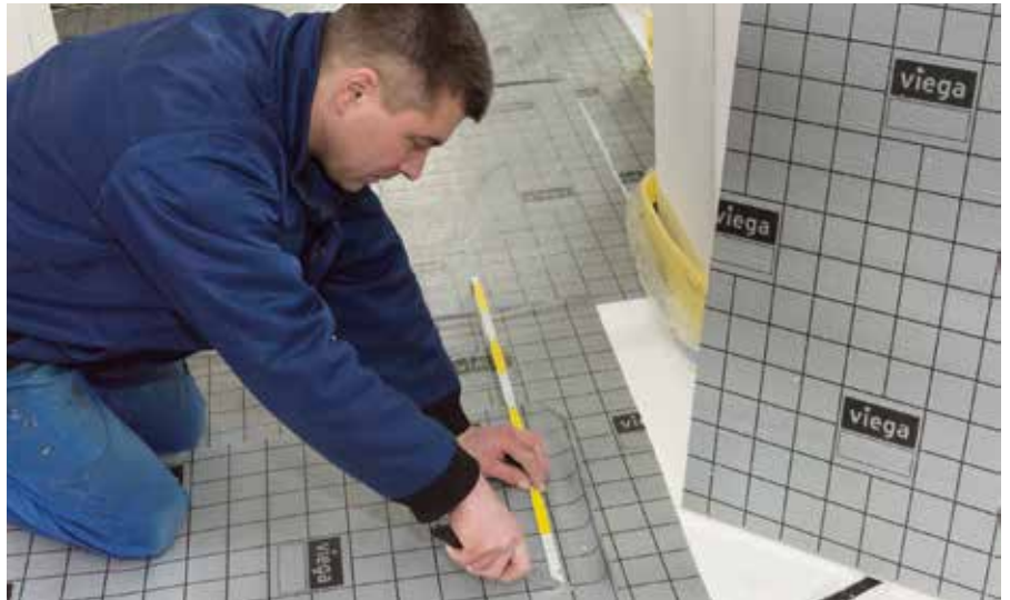
Im ersten Schritt verlegte SHK-Fachhandwerker Markus Schmid im Neubau der Familie Oberloher die 35 mm starke Systemplatte „Fonterra“-Tacker mit Randdämmstreifen auf Dämmung gemäß EnEV.
