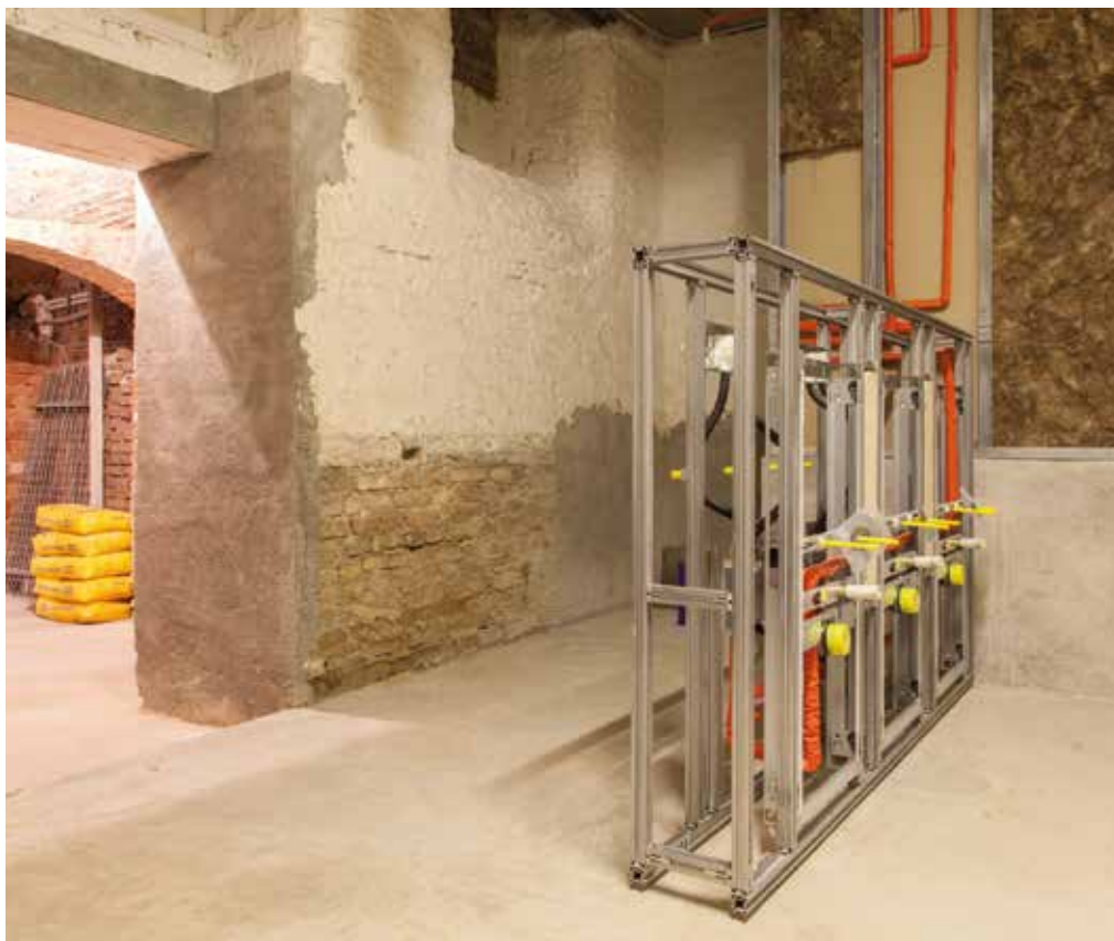
Wenn es schnell gehen soll: Aus dem Geberit Installationssystem GIS, Montageelementen und Systembeplankung entsteht eine komplette, fliesenfertige Sanitärwand für einen großen Waschtisch und drei Urinale.
