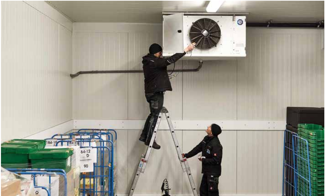
Von der F-Gas-Verordnung am stärksten betroffen ist die Kältetechnik
