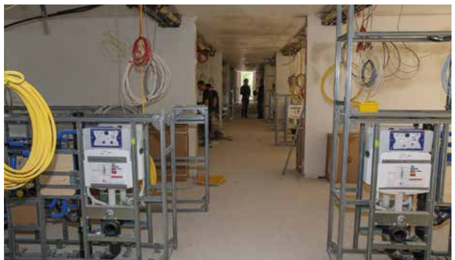
Aus je zwei Teilen der Sanitärwand entstehen so die Trennwände der 36 Hotelzimmer.
