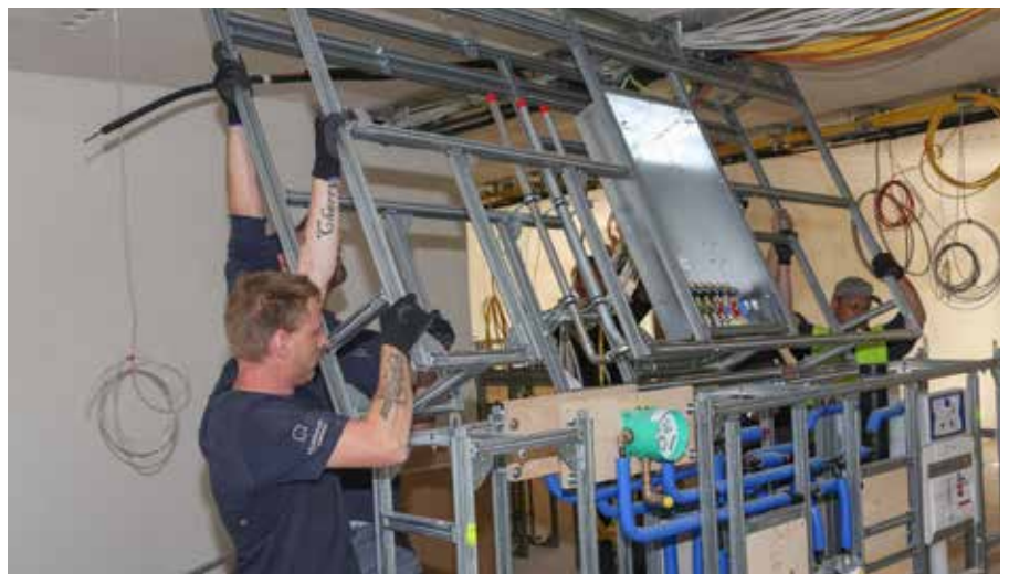
Drei Installateure sind nötig, um die schweren Register übereinander zu setzen und zu befestigen. Anschließend werden die Rohre und Leitungen verbunden.
