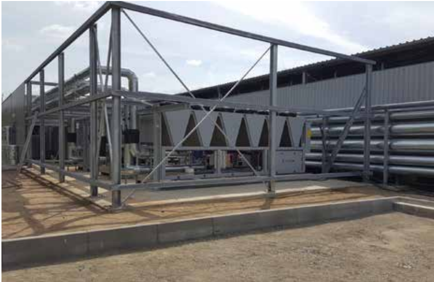
! Zwei Kaltwassersätze plus ein unabhängiges Freikühlmodul von Systemair liefern bis zu 1.430 kW Kälteleistung für das Batteriewerk.
