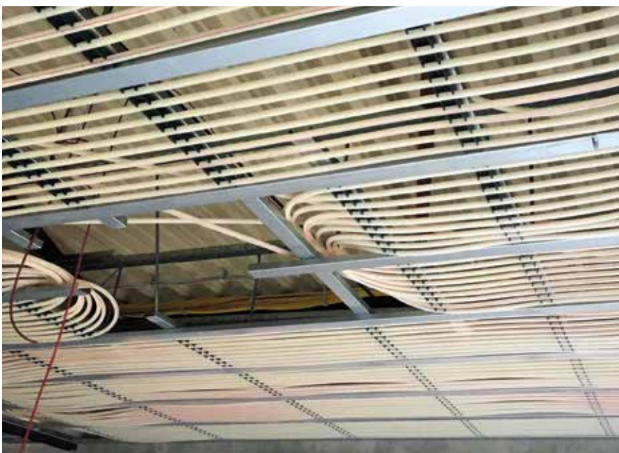
Raumdecken mit Strahlungsflächen in der Bauphase. (Foto: C + P Schlüsselfertiges Bauen GmbH & Co.)
