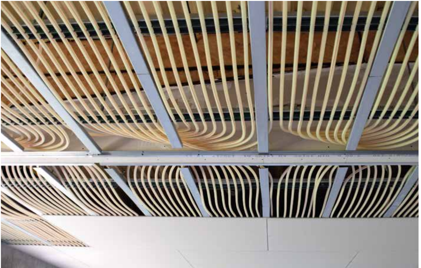
Die Kühldecken verwandeln Raumdecken in Strahlungsflächen, die Räume im Sommer angenehm kühlen. (Foto: C + P Schlüsselfertiges Bauen GmbH & Co.)
