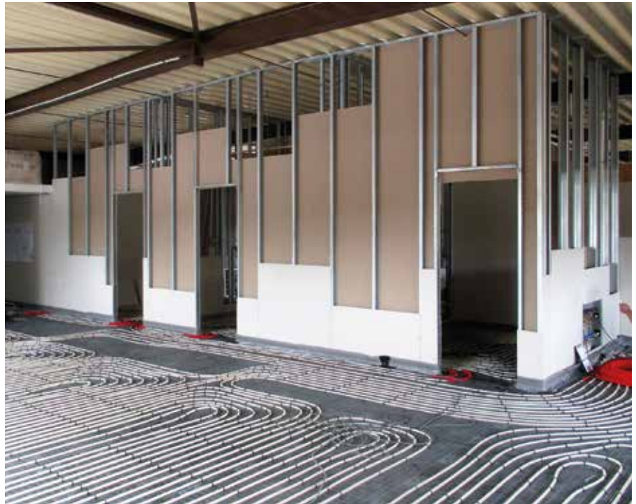
Die Fußbodenheizung ist als Roth Original-Tacker-System ausgelegt.
