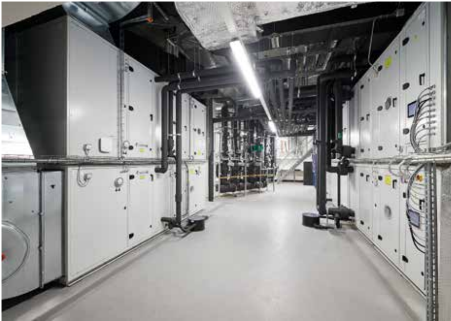
! Blick in eine der beiden von Systemair ausgelegten und inklusive Steuerung realisierten Lüftungszentralen.
