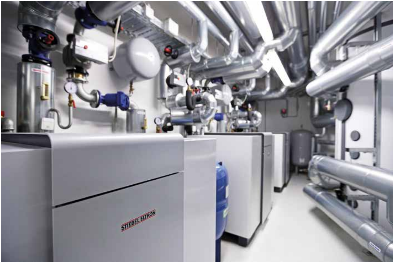
! Drei Großwärmepumpen WPF 52 machen die Wärme aus dem Erdreich nutzbar.
