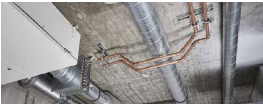
■ Der Systemverbund von Viega zahlte sich unter anderem im Bürotrakt aus, wo die Nachheizung der Lüftungsanlage mit dem Kupfer-Rohrleitungssystem „Profipress“ angebunden wurde.
