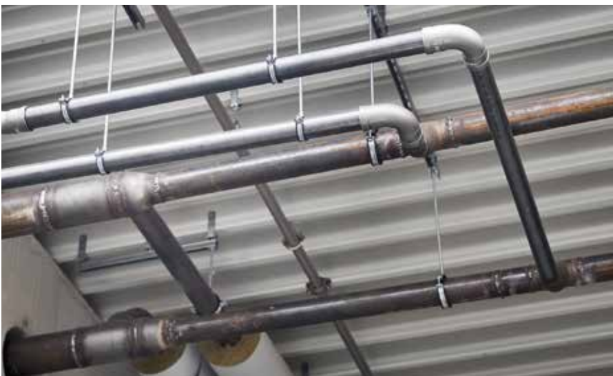
■ Ganz ohne Schweißen ging es auch beim Hallenneubau in Münster nicht. Wo immer möglich, wechselte Thielo Gerding dann aber sofort wieder auf das „kalte“ Pressverbindungssystem „Megapress“. Lichtleisten integriert.
