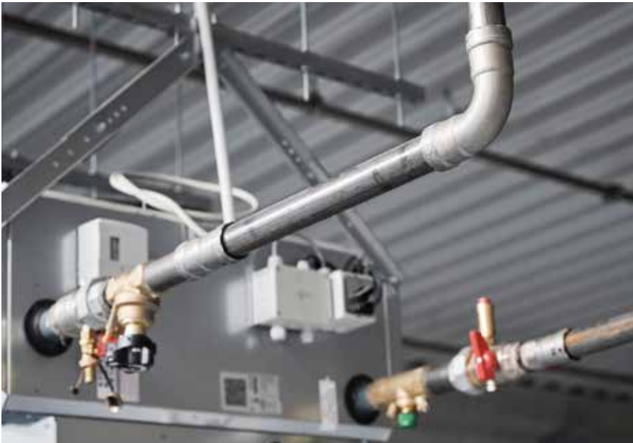
■ Konsequent aus dickwandigem Stahl: Auch die Anbindung der Lufterhitzer unter der Hallendecke wurde mit dem Rohrleitungssystem „Megapress“ umgesetzt.
