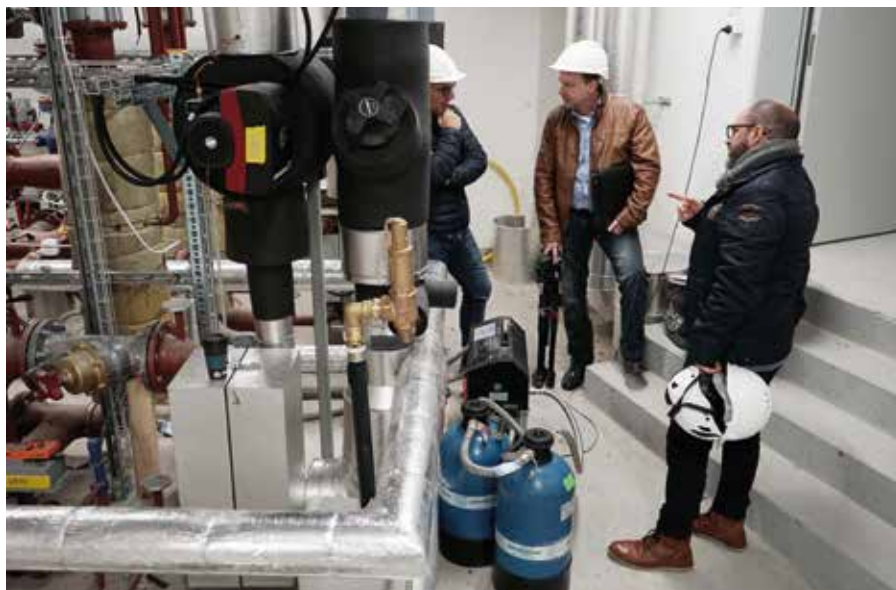
Massimo Covello von der ID Lufttechnik und Anlagenbau AG (rechts) zeichnete als Projektleiter für das Heizungs- und Kältekonzept im Jabe-Tower verantwortlich. Markus Kurz (Mitte) und Gianni Laportosa (links) von perma-trade Wassertechnik dokumentieren vor Ort den Einsatz des Füllwasseraufbereitungssystems perma-Line.
