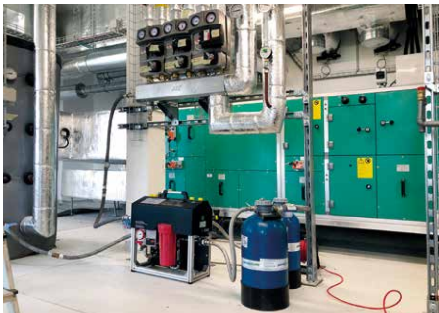
Das Heizsystem des Jabe-Towers wird rein über Wärmepumpen betrieben. Neben Fußbodenheizungen in allen Wohnungen gibt es natürlich auch ein Kälte- und Klimasystem. Auf Grund der extremen Höhe des Objekts mussten bei der Inbetriebnahme verschiedene Druckzonen berücksichtigt werden.
