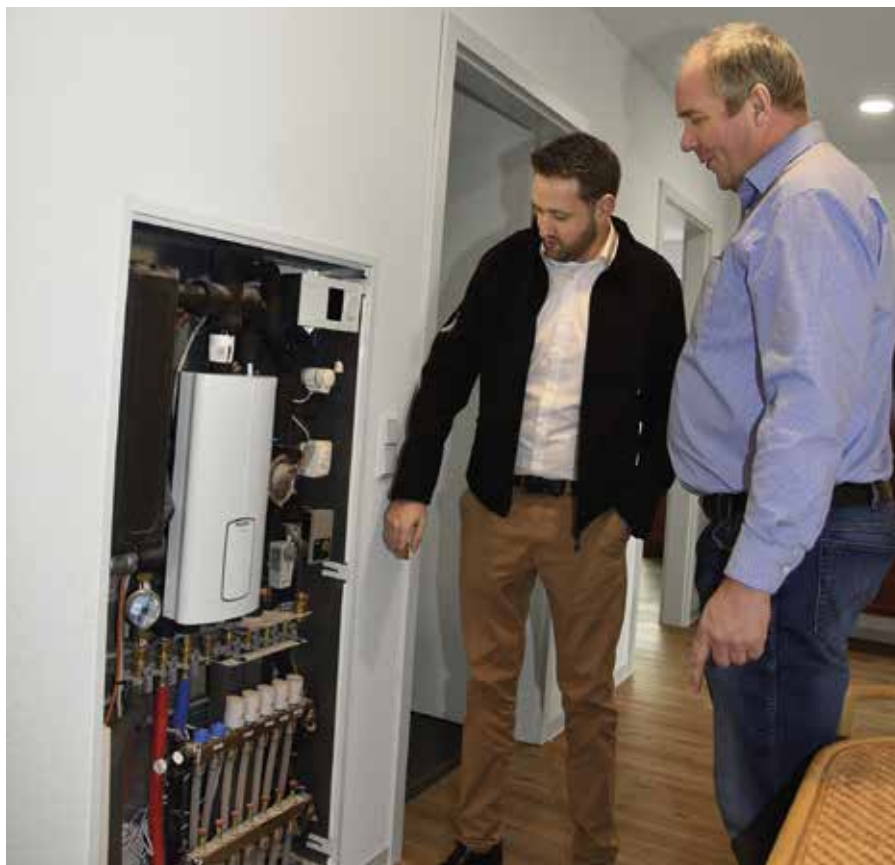
▮ Tobias Pach und Manfred Stahlmann vor einer der Wohnungsstationen, in der die Wärme der zentralen Anlage an das Verteilsystem in der Einheit und an das Trinkwasser übergeben wird. Bei Bedarf sorgt der integrierte Durchlauferhitzer für höhere Warmwassertemperaturen.
