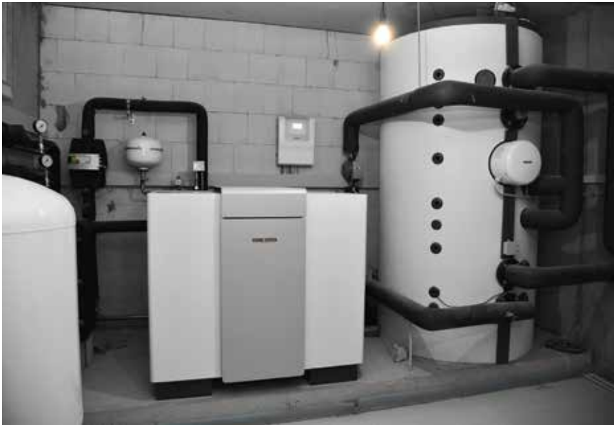
Die Wärmepumpe WPF 27 gewinnt Umweltenergie aus dem Grundwasser, das dafür über einen externen Wärmeübertrager geleitet wird. Im Hintergrund der Wärmepumpenmanager WPM System sowie rechts der 1.500-Liter-Pufferspeicher.
