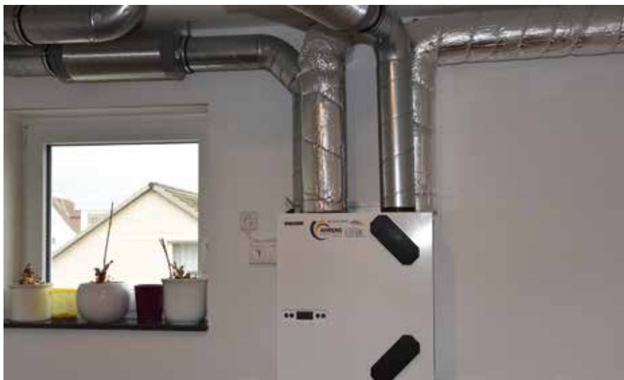
In jeder Wohneinheit komme eine wohnungsweise Lüftungsanlage zum Einsatz - eine LWZ 70 E.
