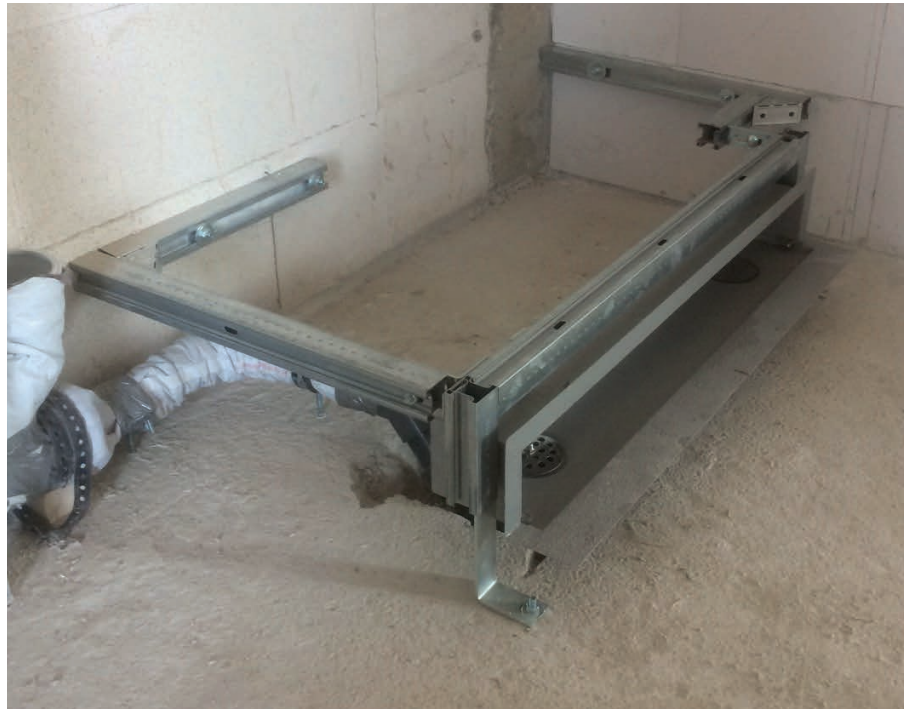
! Schwierige Ausgangssituation für die Ausführung einer bodengleichen Dusche.
