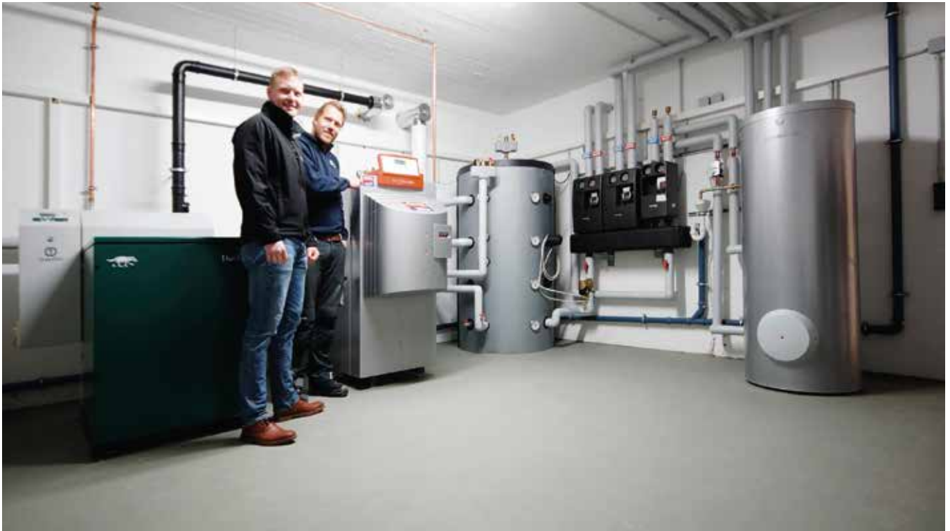
Heizunginstallateur-Meister Roberto Körk (rechts, hier mit Matthias Laber von perma-trade Wassertechnik) von der Firma Bukoll war für Wärmetechnik und Kalkschutz zuständig.
