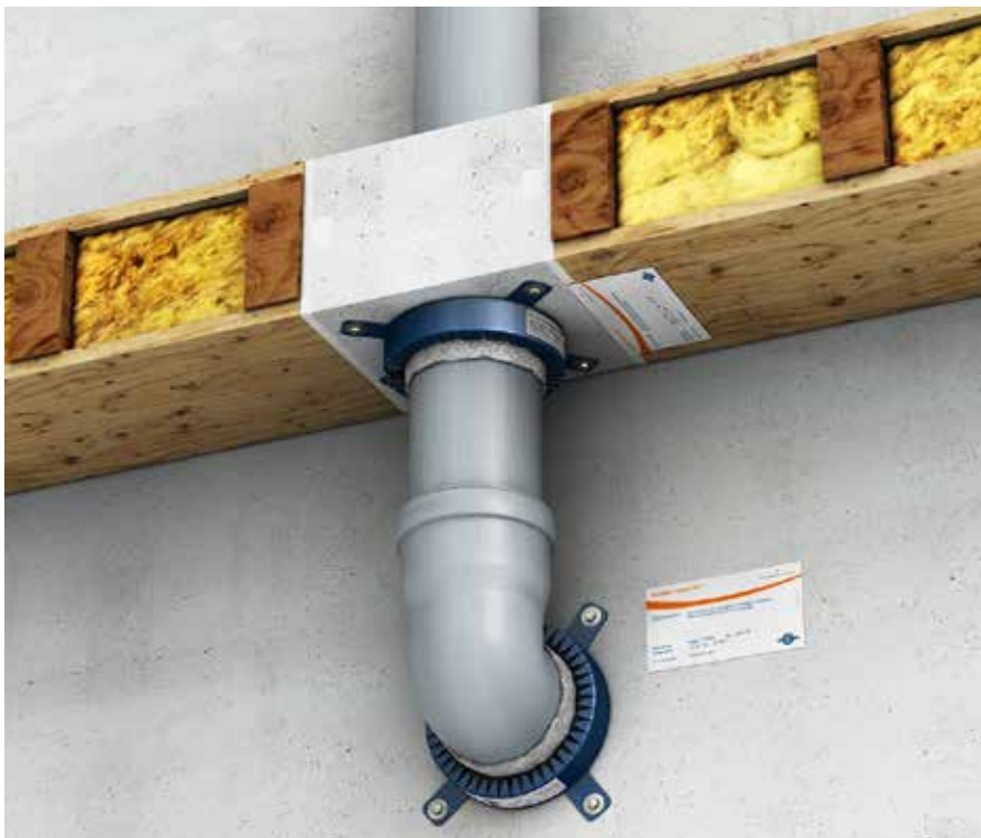
! Zur sicheren und regelkonformen Abschottungen von Leitungen aller Art, können unter anderem Brandschutzmanschetten zum Einsatz kommen.
