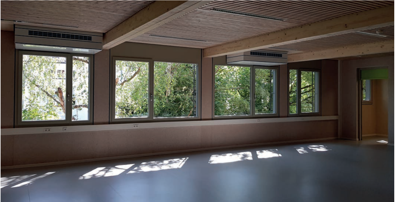
I Die Klassen- und Fachräume der Ursula-Wölfel-Grundschule wurden jeweils mit zwei dezentralen flüsterleisen Lüftungsgeräten des Typs Airflow Duplex Vent 500 HT ausgestattet. Diese wurden an den Decken der jeweiligen Räumlichkeiten angebracht. Kleinere Räume wie die Bibliothek erhielten ein Lüftungsgerät desselben Typs.
