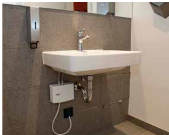
In den WC-Bereichen übernehmen elektronische AEG Kleindurchlauferhitzer die Warmwasserversorgung. Die eingestellte Wassertemperatur wird gradgenau erreicht und kein Wasser bei der Temperaturabstimmung verschwendet.
