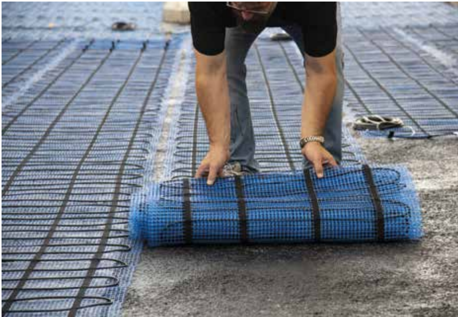
Die Verlegung des hochwertigen, dauerhaft temperaturbeständigen Heizleiters samt Heizmatte erfolgt auf der ersten erkalteten Gußasphaltschicht.
