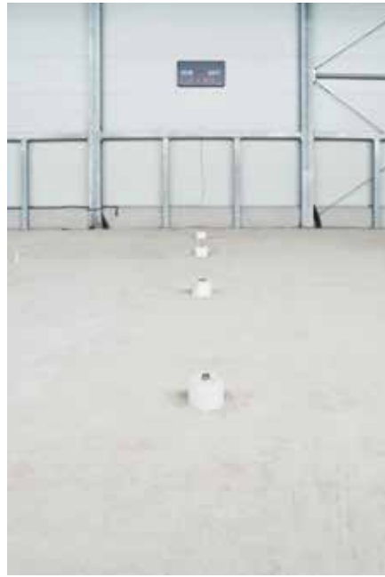
! Die Sporthalle vor Verlegung der Flächenheizung. Mittig befinden sich die Bodenhülsen und Befestigungsanker für die Turngeräte.
