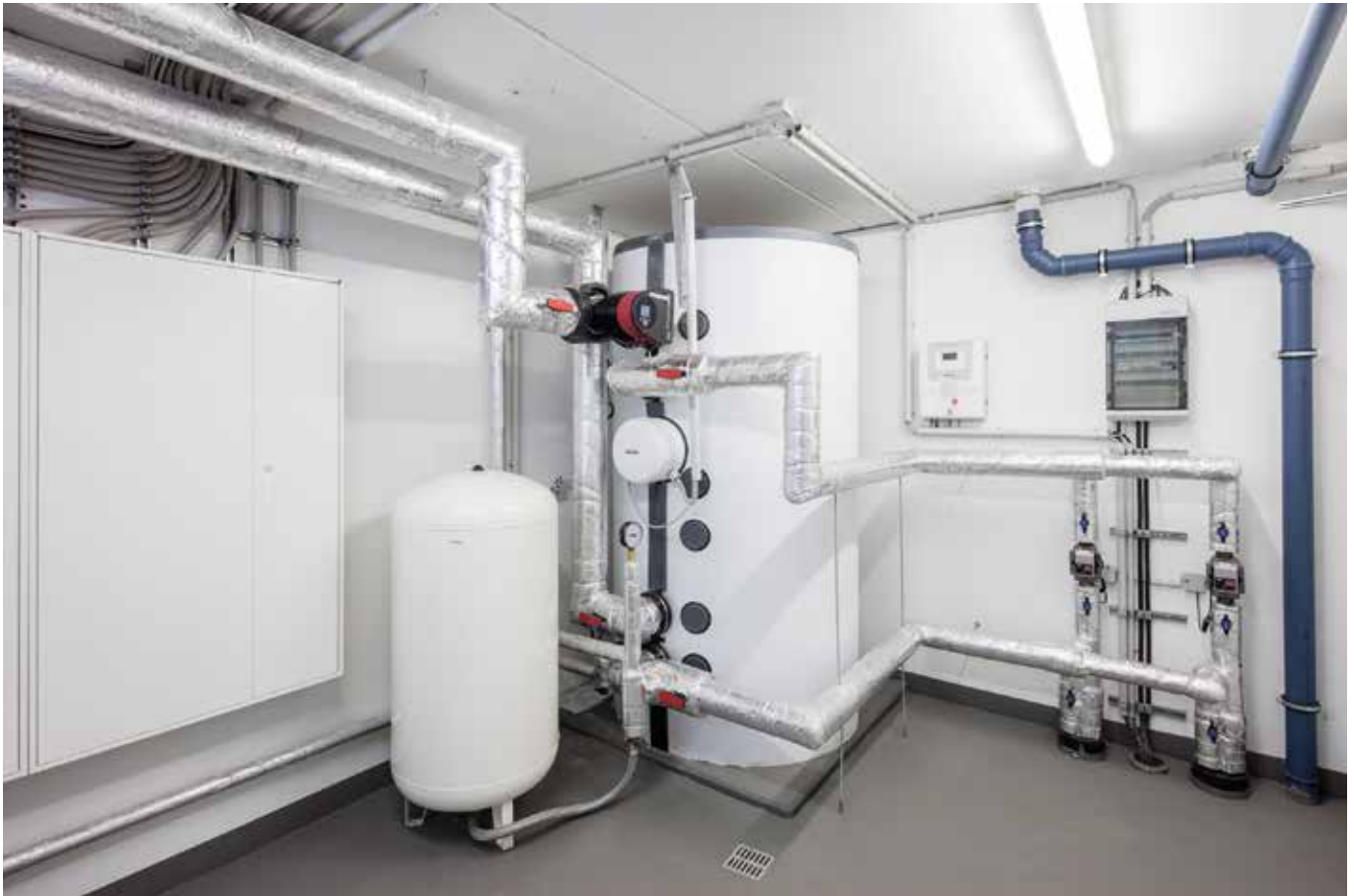
Im Technikraum wird die Wärme in einem 1.500-Liter-Speicher bevorratet.
