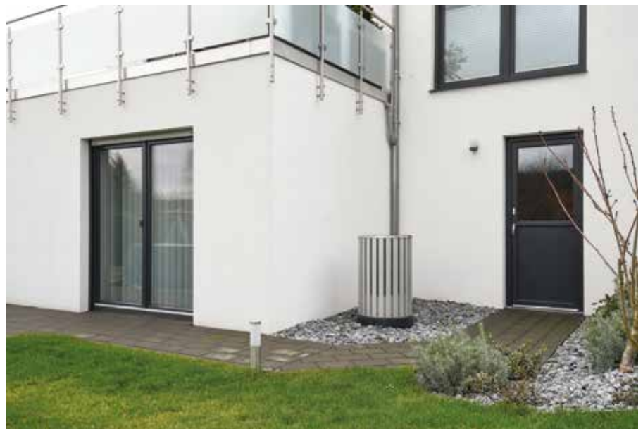
! Das Außenmodul der ARTstyle-Wärmepumpe wurde mit dem vorgesehenen Abstand von 70 cm vor der Wand aufgestellt.
