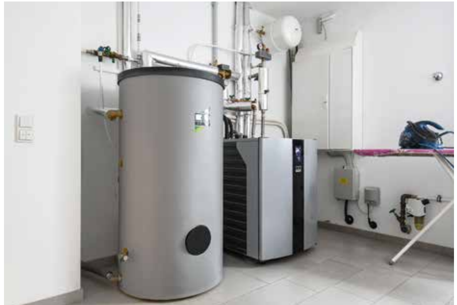
Das Innenmodul der ARTstyle-Wärmepumpe und der Warmwasserspeicher benötigen nur wenig Platz im Hauswirtschaftsraum.
