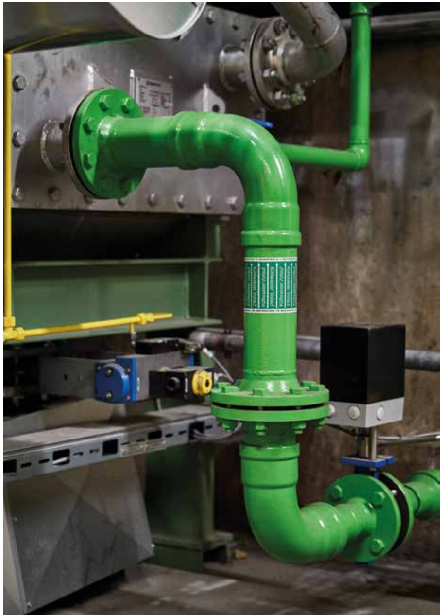
! Auch beim Kühlwassersystem wurde „Megapress“ eingesetzt; hier in DN 100 und nachträglich lackiert.
