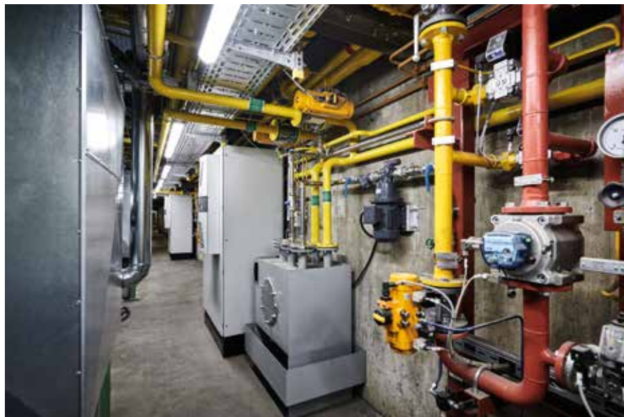
Knapp bemessene Räume und die Dichte der medienführenden Rohrleitungen im Bestand war eine der Herausforderungen bei der Neuinstallation im Kellergeschoss unter der Glühe.
