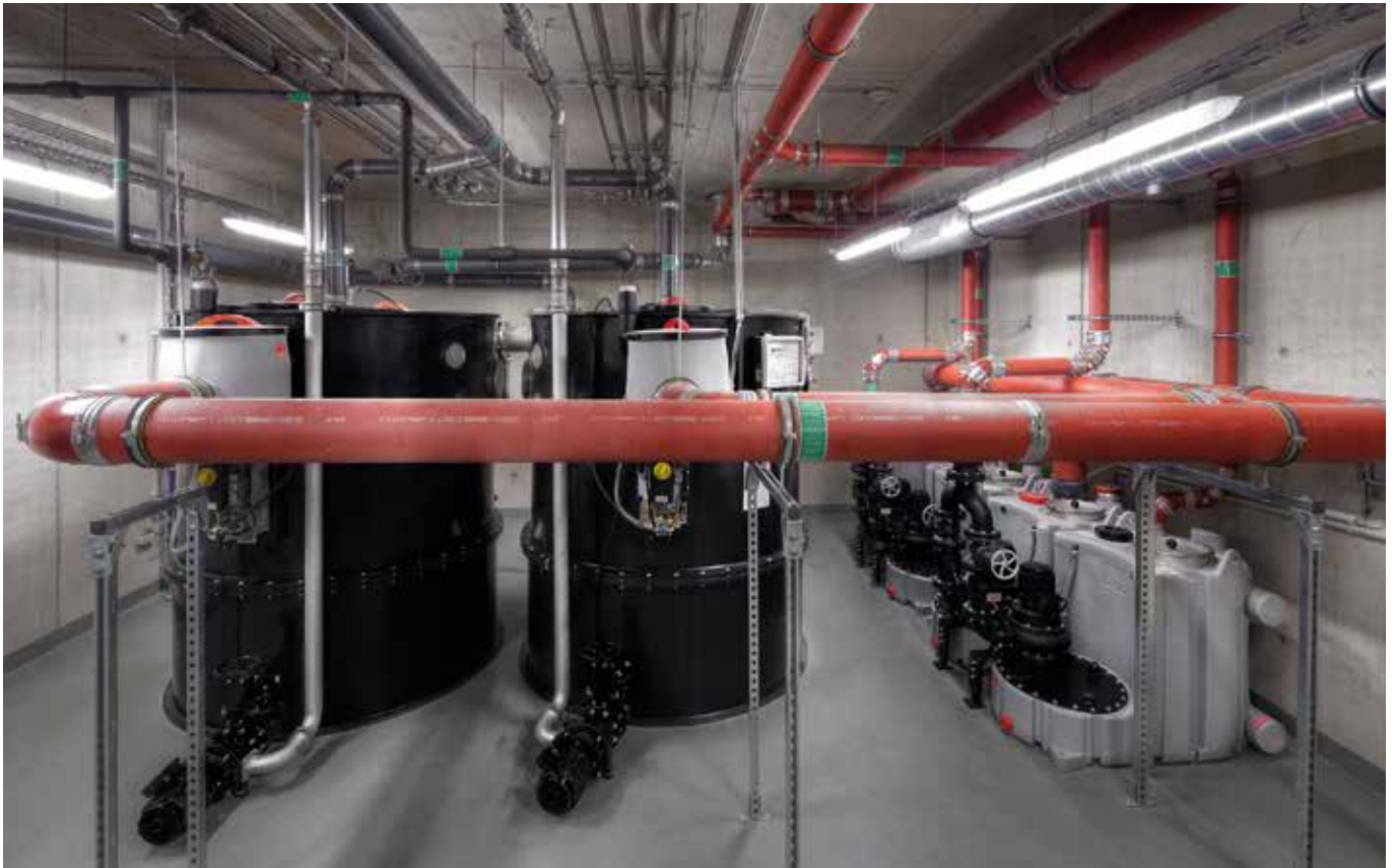
! Blick in den „Maschinenraum“ der neuen Mensa Garching: Links ein Fettabscheider aus Polyethylen Ausbaustufe 3 und rechts eine Doppel- Hebeanlagen in Parallelbauweise, beide von ACO Haustechnik.
