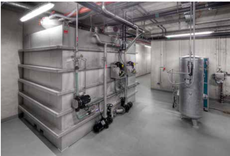
! Für die Nassmüll-Entsorgung hat ACO Haustechnik eine individuell gefertigte Anlage mit Sammelntank aus Edelstahl geliefert.
