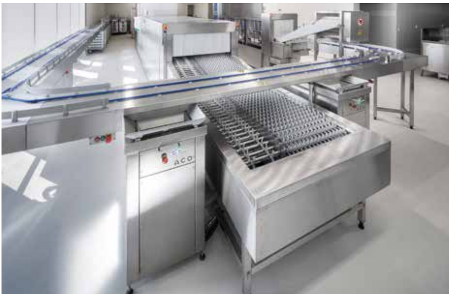
Startpunkt der Nassmüllentsorgung: die Eingabestationen für den Nassmüll-Sammeltank.
