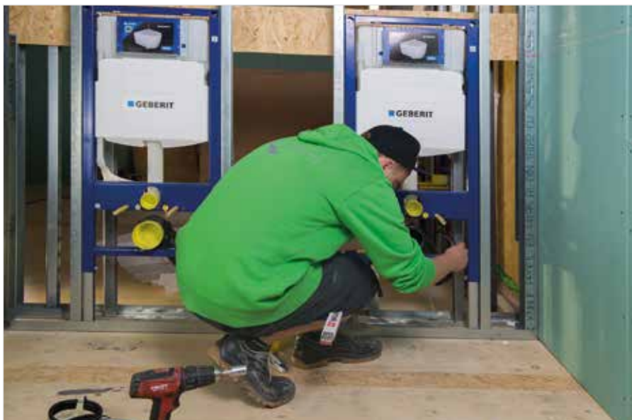
Duofix Elemente mit Sigma Unterputz-Spülkasten von Geberit werden auch bei den WCs eingebaut. Sie lassen sich leicht installieren, sind robust und strapazierfähig für den langjährigen Einsatz in stark frequentierten Sanitärräumen.
