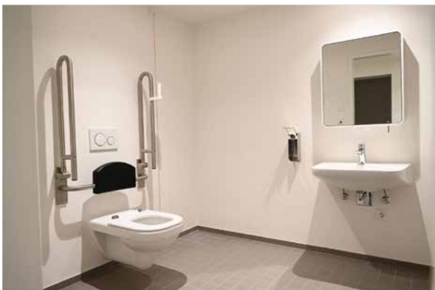
Für hohes Besucheraufkommen gerüstet: Im fertigen Sanitärraum zeigt sich die geschlossene Keramik des iCon Wand-WCs mit der Sigma50 Betätigungsplatte in gebürstetem Chrom.
