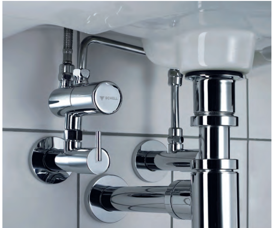
! Abbildung 5: Sind an Eckventilen oder in Waschtisch-Armaturen Thermostate zum Schutz der Nutzer installiert, so muss die Probenahme und die Ermittlung der Systemtemperatur im Rahmen von Legionellenuntersuchungen unbedingt vor den thermostatischen Einrichtungen erfolgen.
