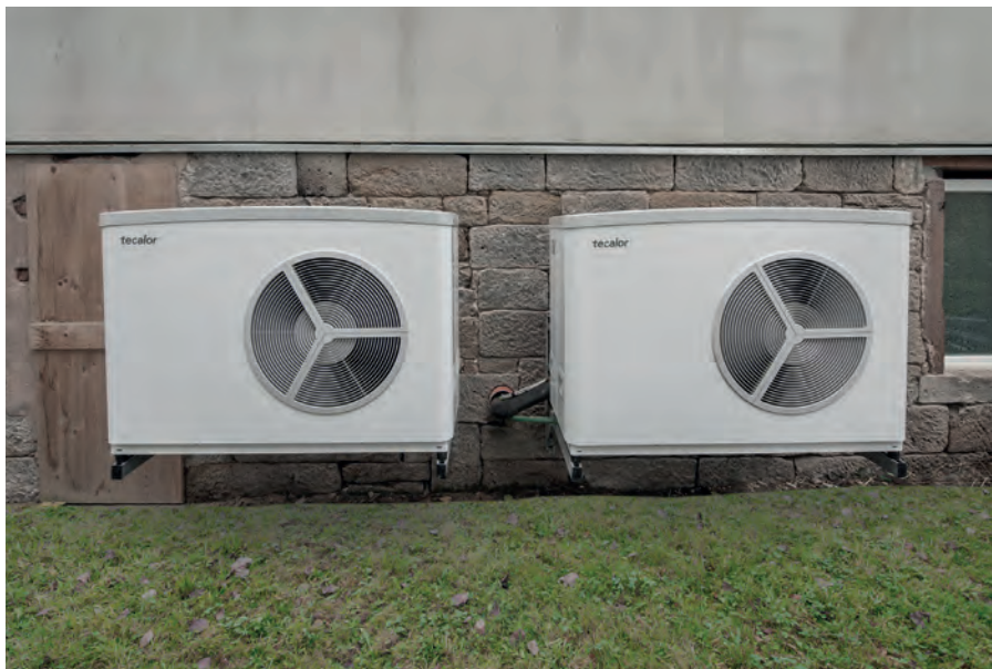
Um den Heizwärmebedarf des Mehrfamilienhauses zu decken, verknüpften die SHK-Handwerker zwei Wärmepumpen des Typs TTL 25 A von Tecalor zu einer Kaskade.
