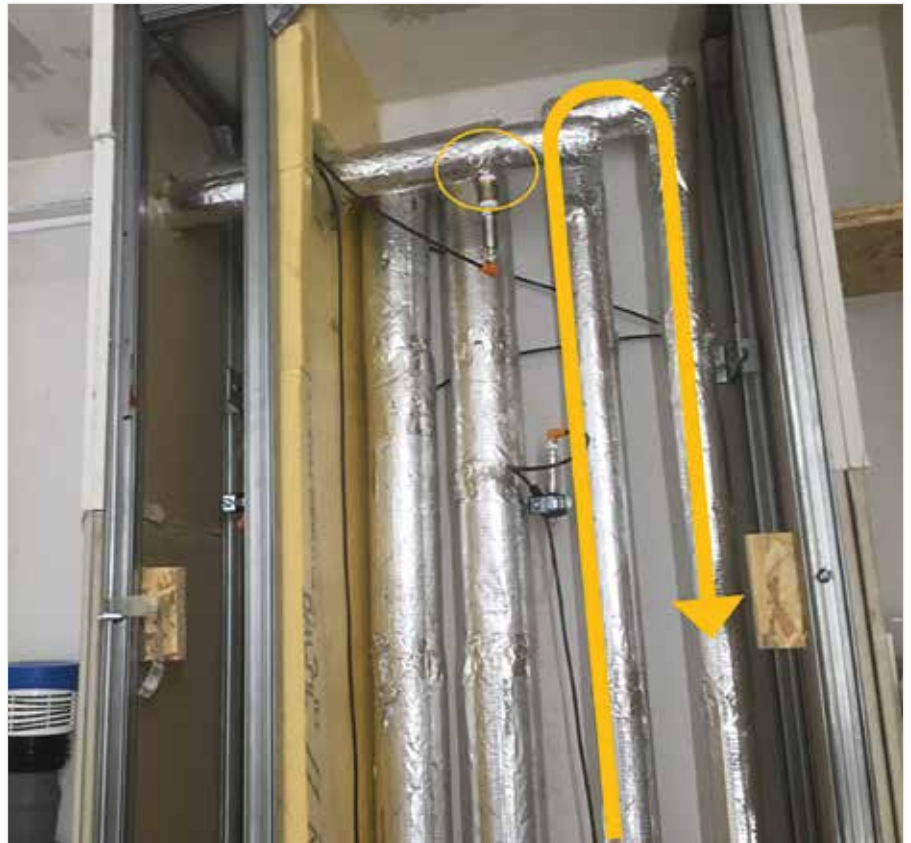
Abb. 2: An jedem Abzweig einer zirkulierenden Warmwasserleitung ergibt sich während Stagnationsphasen systematisch ein hohes Risiko für Legionellenwachstum aufgrund der langen Verweilzeit des Wassers im Abzweig bei ungünstigen Temperaturen.
