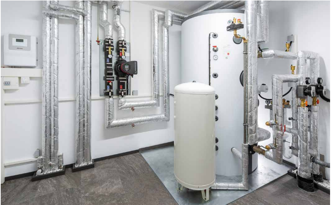
Im zentralen Technikraum befindet sich die Wärmepumpenregelung (links) sowie der 1.500-Liter-Pufferspeicher, über den die Wohnungsstationen mit Wärme versorgt werden.
