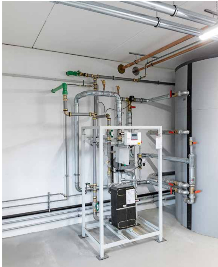
Trinkwasser-, Heizungs- und Betriebswasser-Installationen in unmittelbarer Nachbarschaft, und alle aus dem Viega-Systemverbund: Blick in eine der Wärmezentralen des Neubaus.
