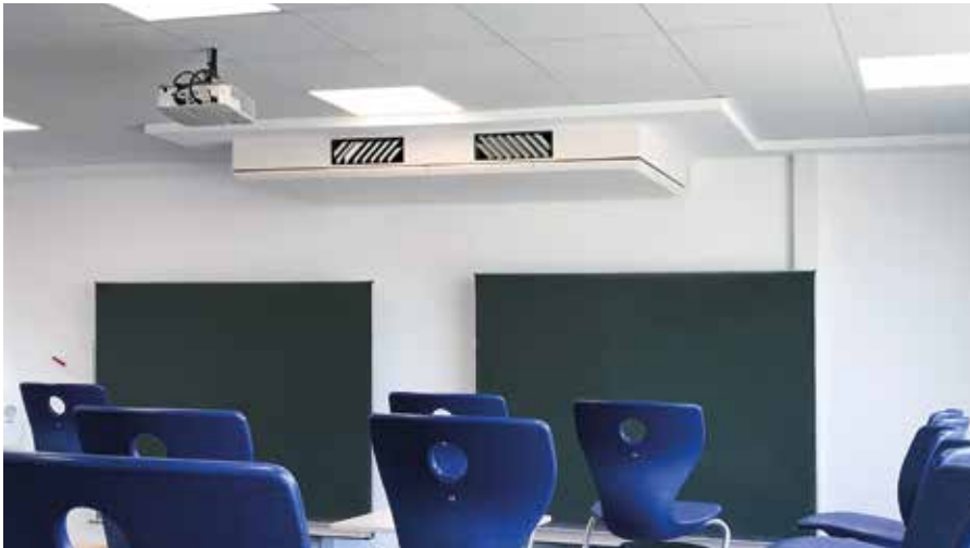
Das Lüftungsgerät fügt sich auch optisch gut in den Klassenraum ein.
