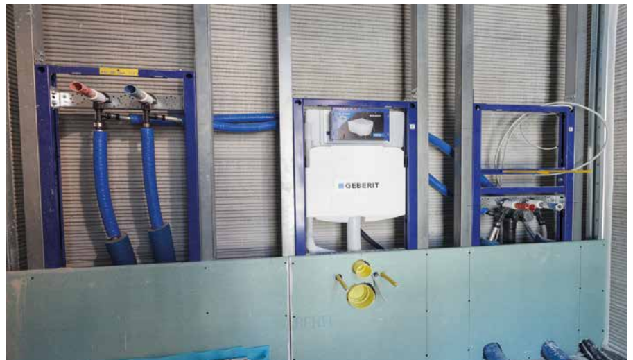
In der Vorwand setzt der Installateur auf das Geberit Duofix System, bestehend aus Systemschienen und -ständern.
