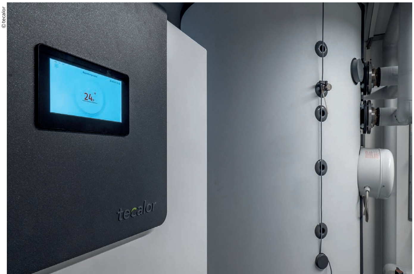
Die vollautomatische außentemperaturabhängige Regelung der Heizungsanlage übernimmt der integrierte Wärmepumpen-Manager mit Farb-Touchscreen.
