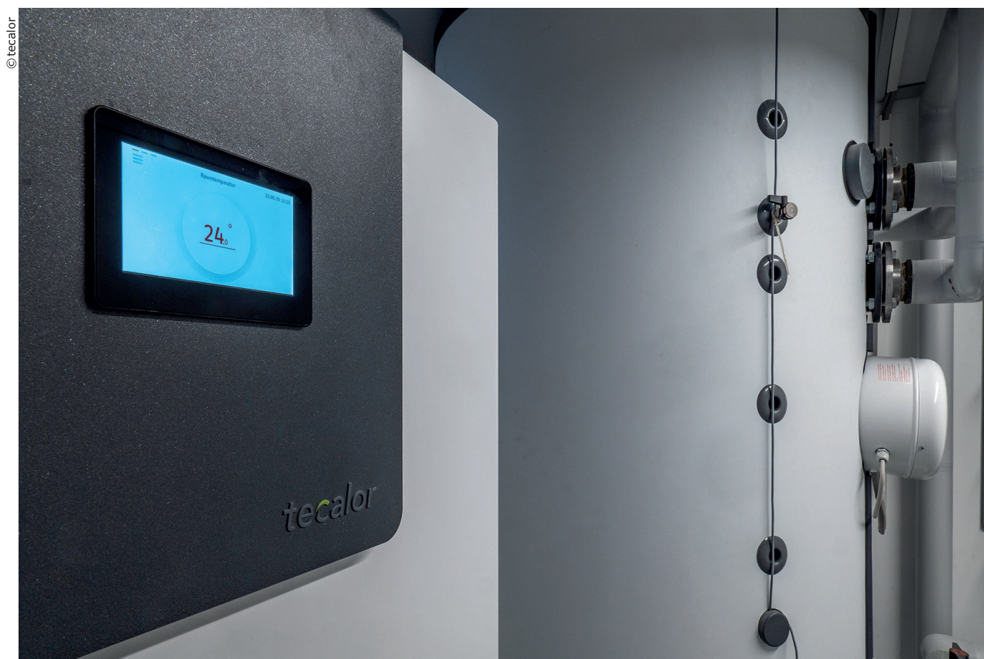
Die vollautomatische außentemperaturabhängige Regelung der Heizungsanlage übernimmt der integrierte Wärmepumpen-Manager mit Farb-Touchscreen.
