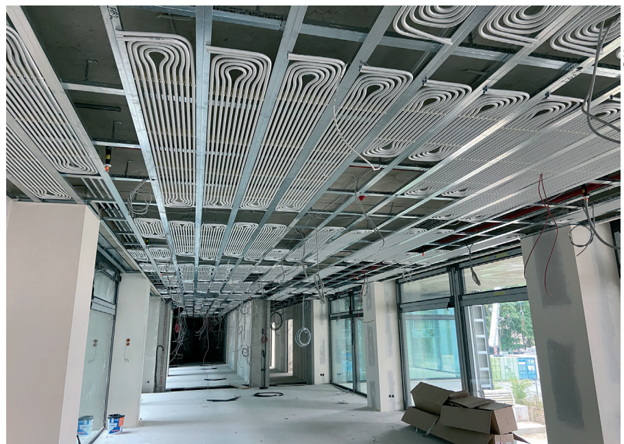
! Alle 13 Geschosse sind mit der Deckenheizung und -kühlung Uponor Thermatop M ausgestattet. Die Module werden in die Profile der abgehängten Deckenkonstrukti-
