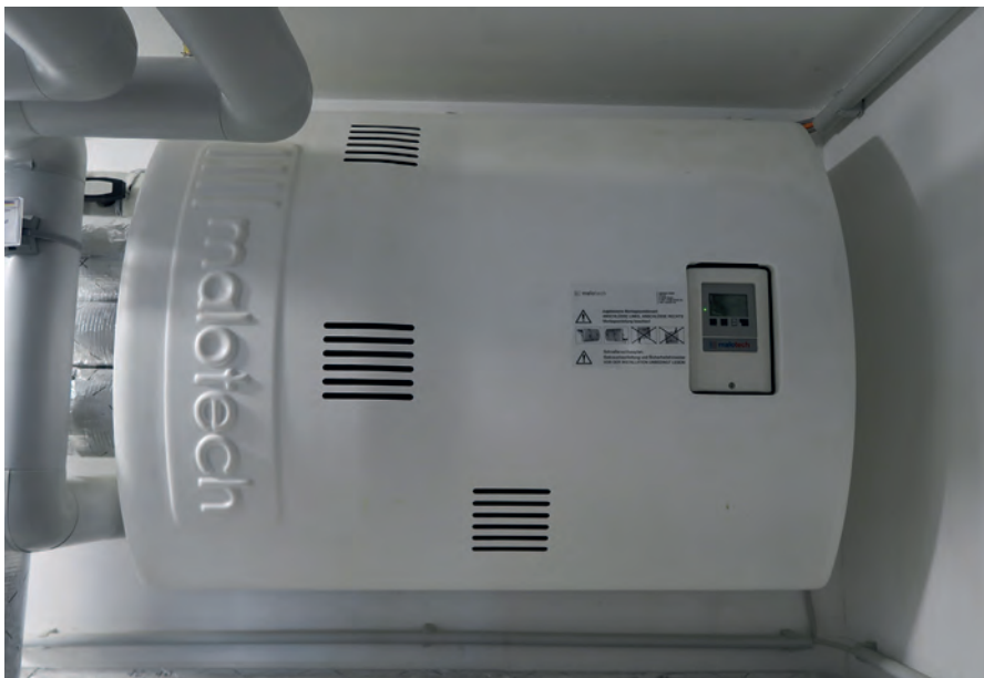
I oben: Die Heizanlagensteuerung ISR HSM-M von Brötje sorgt für den optimierten Einsatz der hybriden Wärmeerzeuger. unten: Das Frischwassermodul von Malotech gewährleistet hygienisches Trinkwarmwasser auf gleichbleibendem Temperaturniveau.
