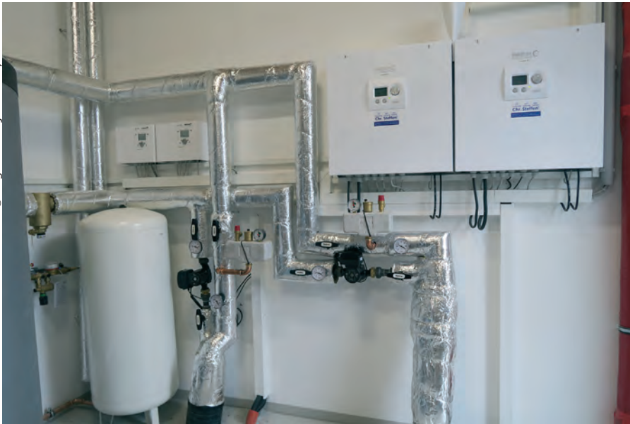
Alles geregelt: Die Bedieneinheiten der Wärmepumpen-Kaskade befinden sich in einem großzügig dimensionierten Technikraum.
