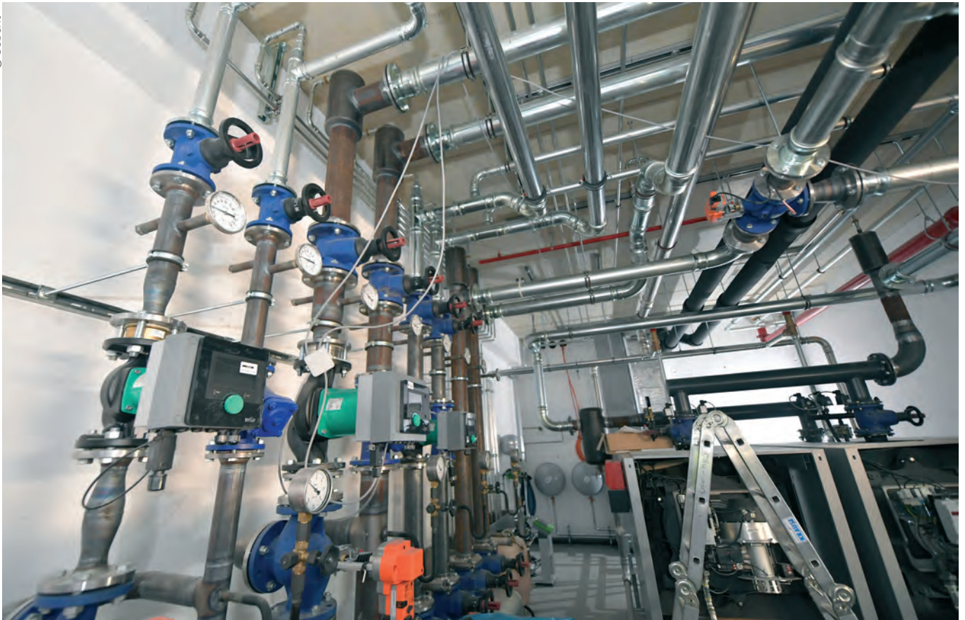
Material-Mix in der Hauptverteilung: Geflanschte Passstücke und andere Verbindungen größerer Dimension schweißt das SHK-Unternehmen selbst. Ansonsten bestimmt Mapress C-Stahl den weiteren Verlauf der Leitungen.
